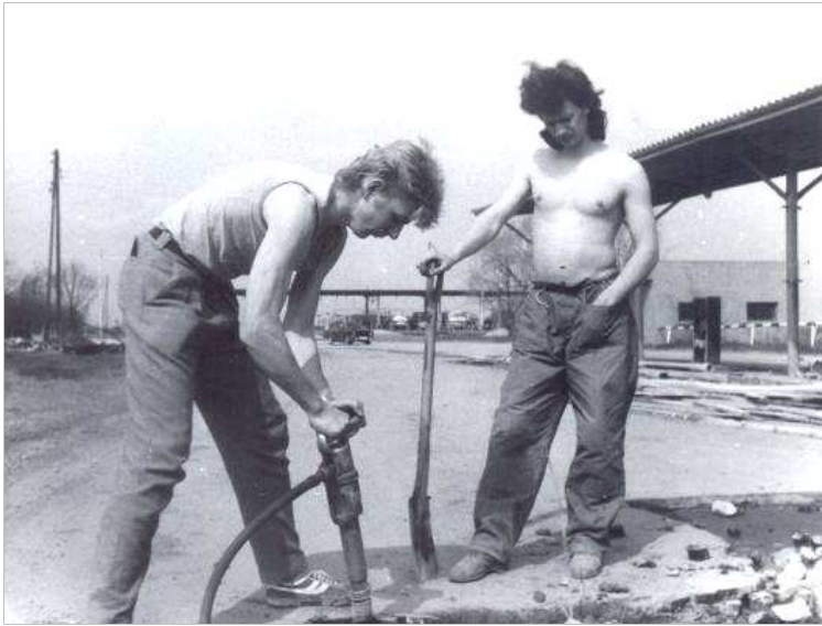
Asfalta drupināšana ar pneimatisko āmuru prakses laikā 1989. gada vasarā Bauskas Degvielas uzpildes stacijā. (Foto no A.Putniņa arhīva) No kreisās: Aivars Putniņš , Ivars Tihovskis.
