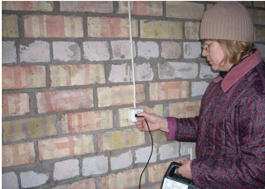
2.4. att. Uzlādes rozete garāžā tiek izmantota elektrovēlspēda uzlādei
