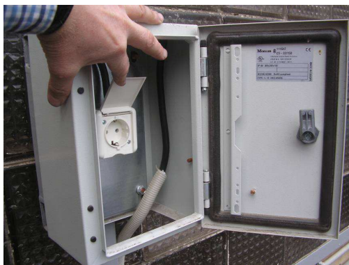
2.6. att. Vienkāršas konstrukcijas 220 V 16 A elektrouzlādes punkts, kuru var izvietot pie garāžas vai dzīvojamās ēkas sienas vai uz metāla stabiņa
