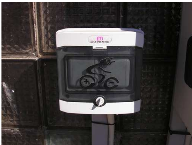
2.20. att. Sadales skapis divriteņu elektropēkratu uzlādei
