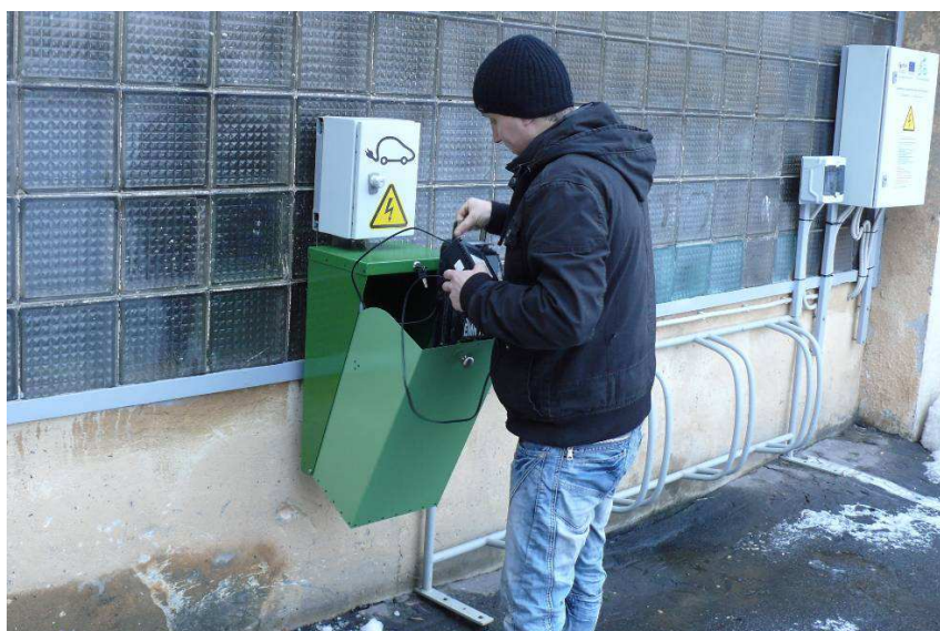
3.73. att. Lādēšanas iekārtas un akumulatoru bloka ievietošana uzlādes skapī
