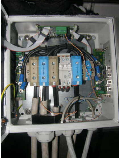
3.105. att. UIT mēritāja uzstādīšana saules bateriju kontrolera skapī
