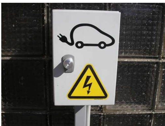
2.21. att. Sadales skapis elektroautomobiļu uzlādei
